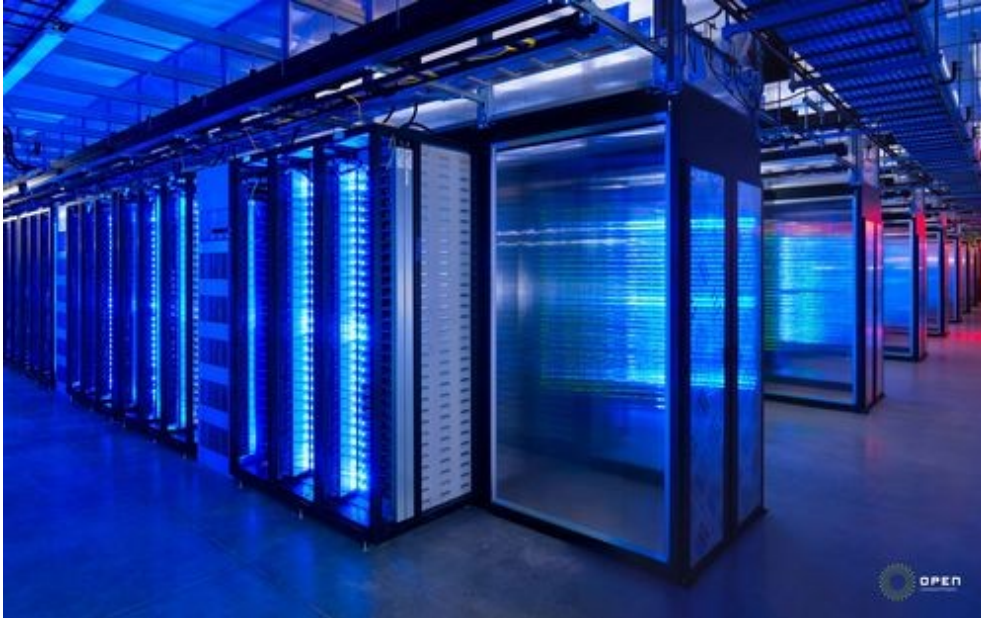
Une salle d'hébergement de serveurs ou data center
